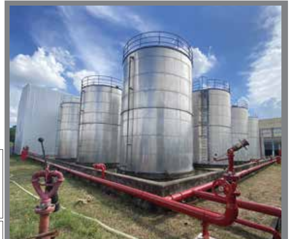
ทางบริษัทฯ รับตรวจสอบประสิทธิภาพน้ำยาโฟมดับเพลิงตามมาตรฐาน NFPA ที่ห้องแล็บในประเทศสหรัฐอเมริกา
